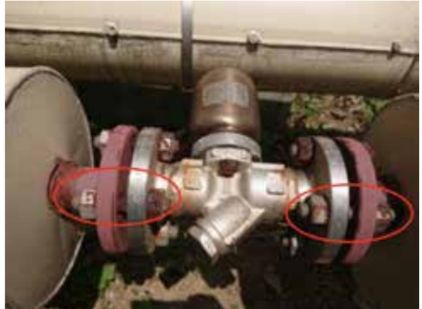
圖 2 觀音工業區烘覆型螺栓銹蝕
