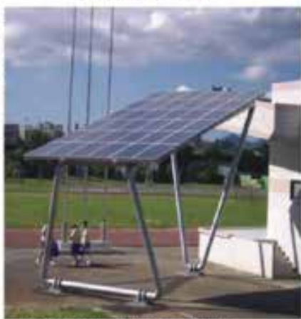
板橋國中太陽光電結構
