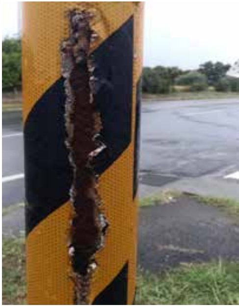
圖 1 新竹香山海山港路燈電桿反光紙表面受到破損後之腐蝕狀況
