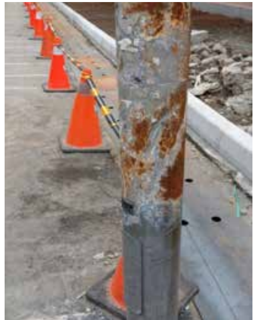
圖 4 樹林千歲路燈電桿反光紙表面受到破損後之腐蝕狀況
