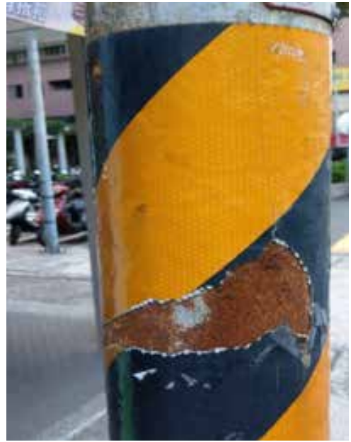
圖 2 五股成泰路燈電桿反光紙表面受到破損後之腐蝕狀況
