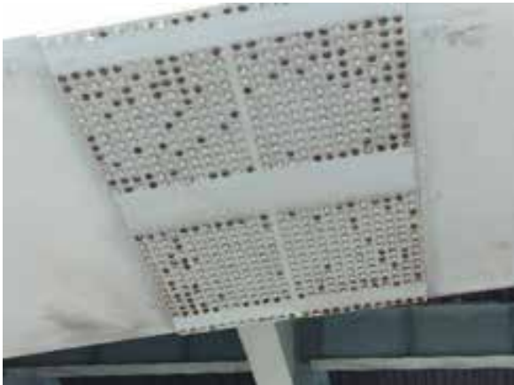
圖 1 台 64 快速道路重翠大橋螺栓銹蝕
