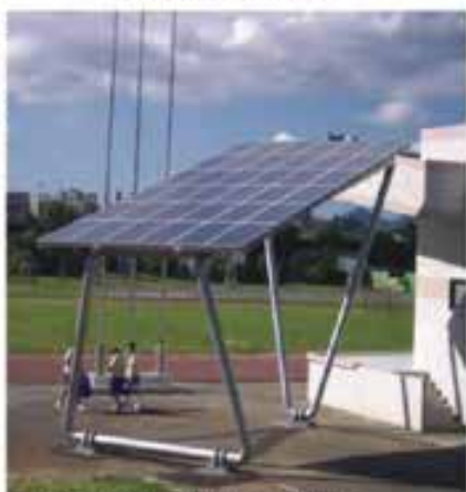
板橋國中太陽光電結構
