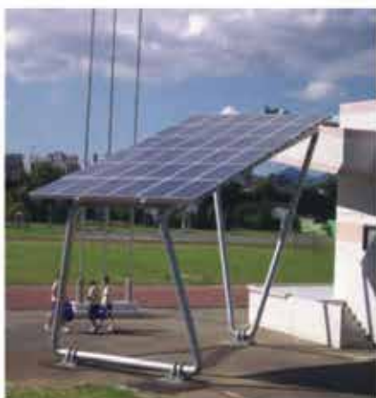
板橋國中太陽光電結構
