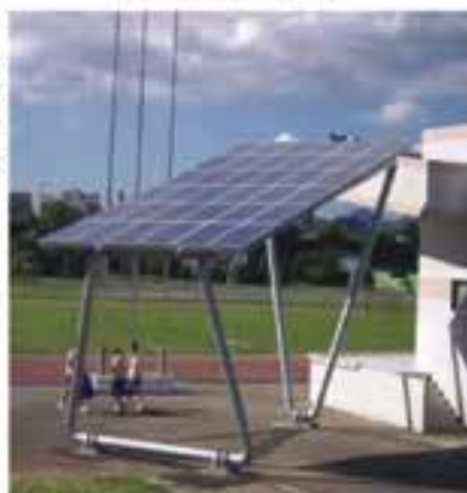
板橋國中太陽光電結構
