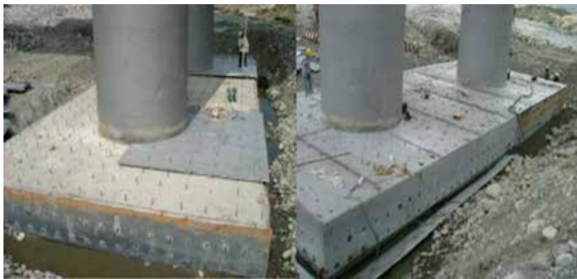
照片 10. 台 3 蘭勢大橋基樁樁帽（基礎版）頂、側面以熱浸鍍鋅鋼板保護 [2]
