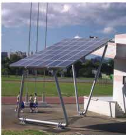
板橋國中太陽光電結構
