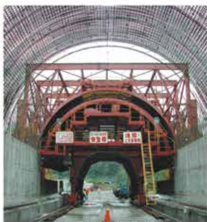
高鐵隧道內外鋼模台車
