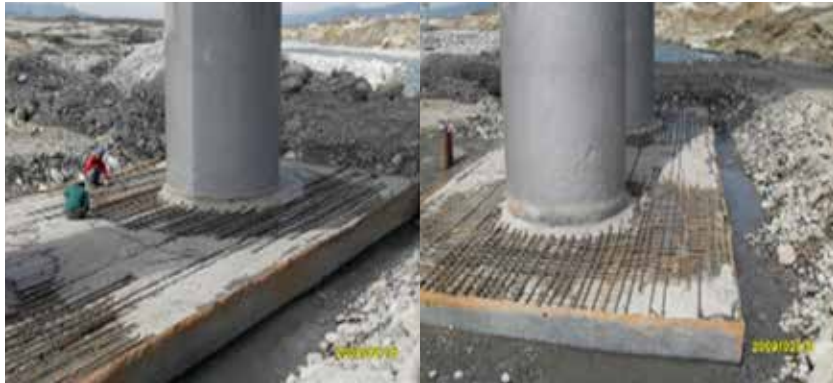
照片 9. 台 3 線蘭勢大橋樁帽頂混凝土被沖刷鋼筋外露 [2]
