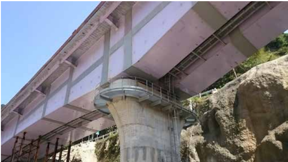
圖 5. 橋梁熱浸鍍鋅維修與檢查步道
