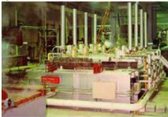
圖 2. 線材用陶瓷爐一號爐
