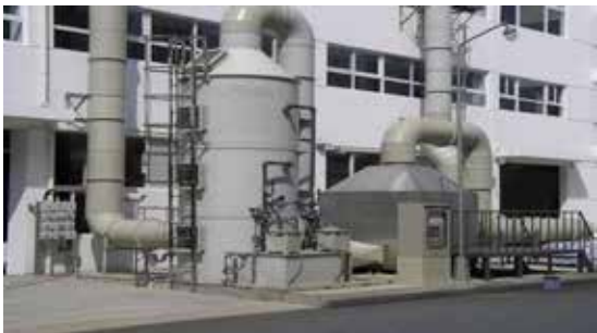
相片 1-1. 酸洗洗滌塔設備外觀
