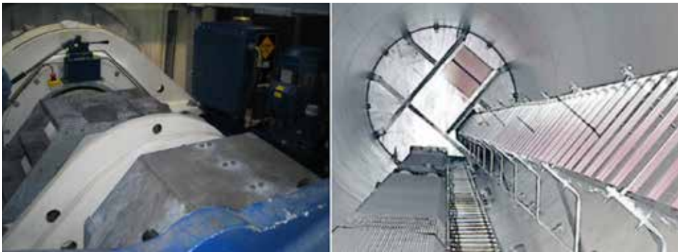
圖 5 風力發電機機艙內部塔步齒輪箱、樓梯、平台格柵板
