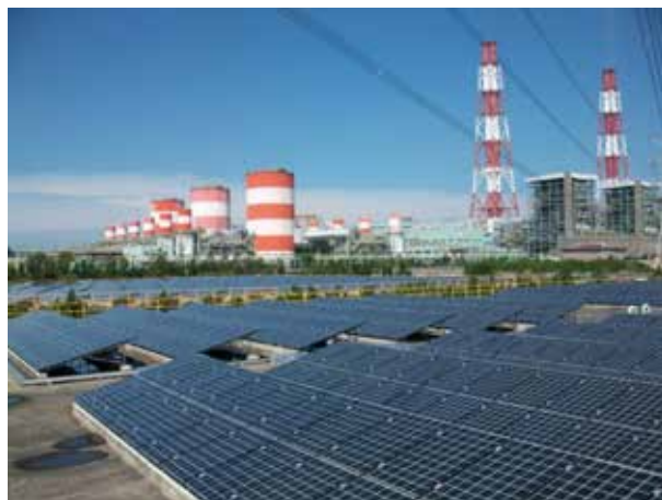
圖 1、發電廠生水池 PV (953kWp)
