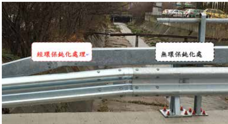
圖 4、高速公路護欄經測試一年後之外觀
