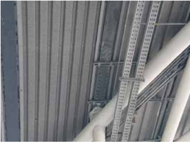
圖 15、機場捷運配電系統線槽 (cable tray)
