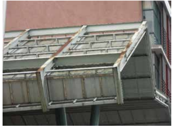
圖 5、新店線七張站 1 號出口雨庇生銹情形
