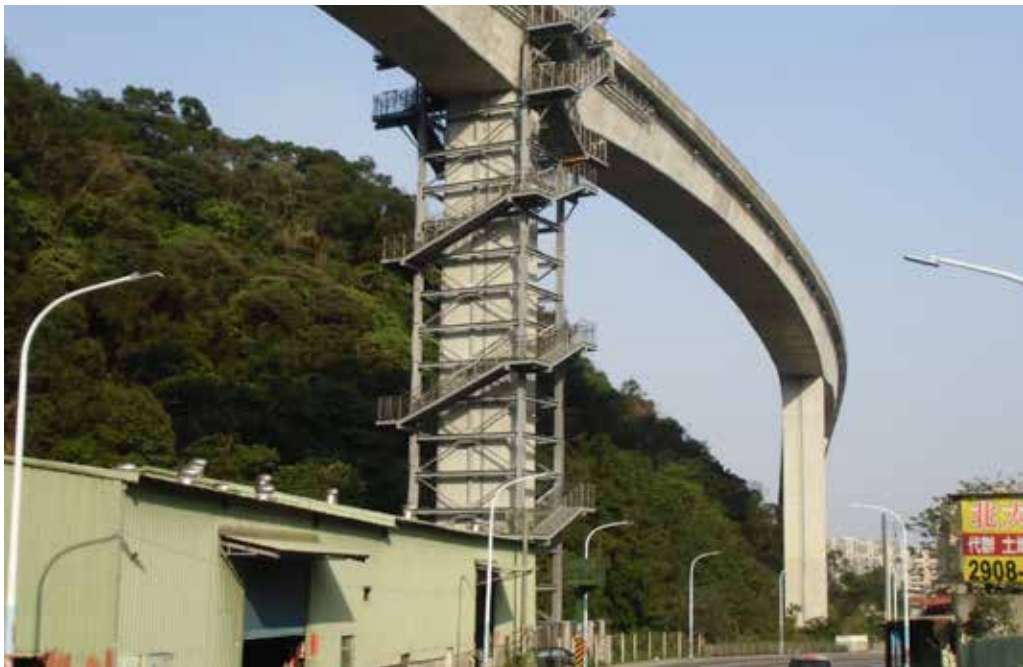
圖 12、機場捷運 A6 與 A7 站間逃生設施(經熱浸鍍鋅)
