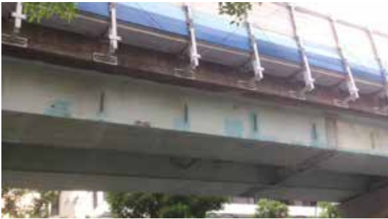
圖 4、文湖線民權東路口鋼橋生銹情形
