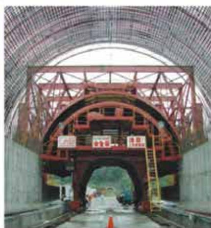
高鐵隧道內外鋼模台車
