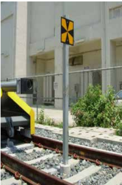
圖 11-1 號誌系統~台灣高速鐵路全線道旁標誌板
