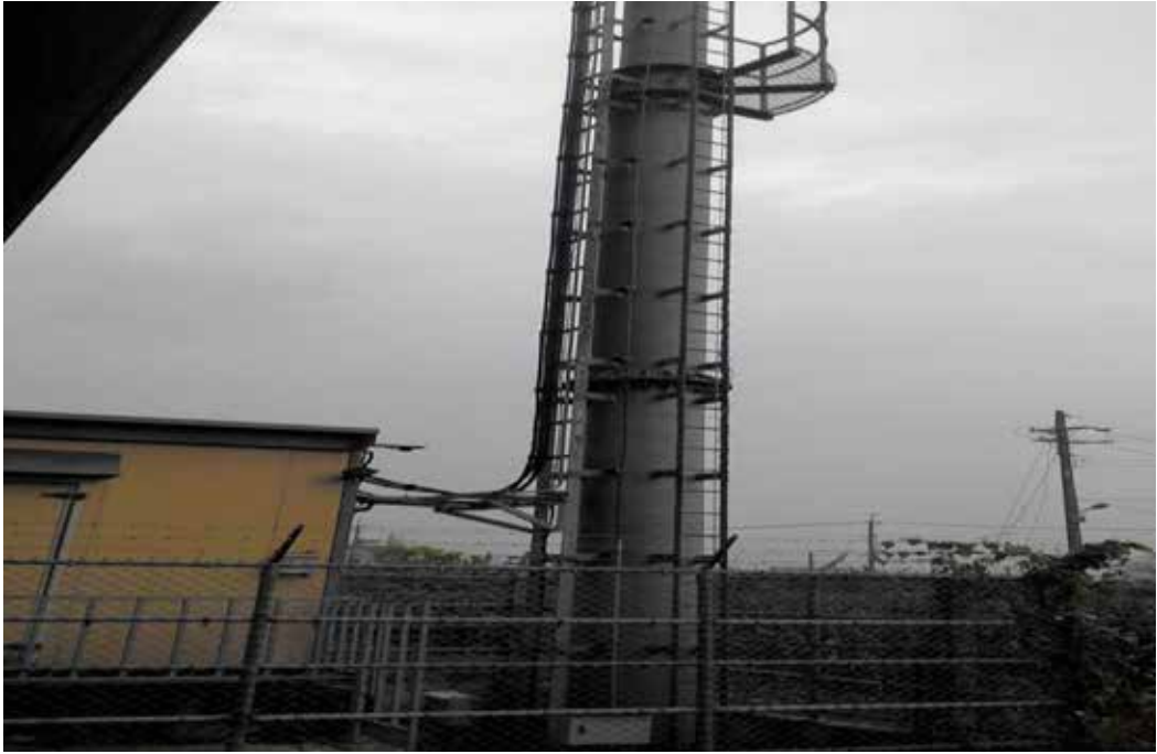
圖 12 通信系統~沿線無線電通信系統機房
