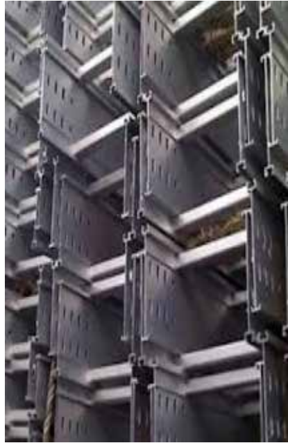
圖 15 高鐵電器設備用熱浸鍍鋅線槽
