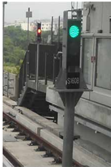
圖 11-2 道旁號誌設備 - 裝於支柱上之雙燈號式 LED 號誌機
