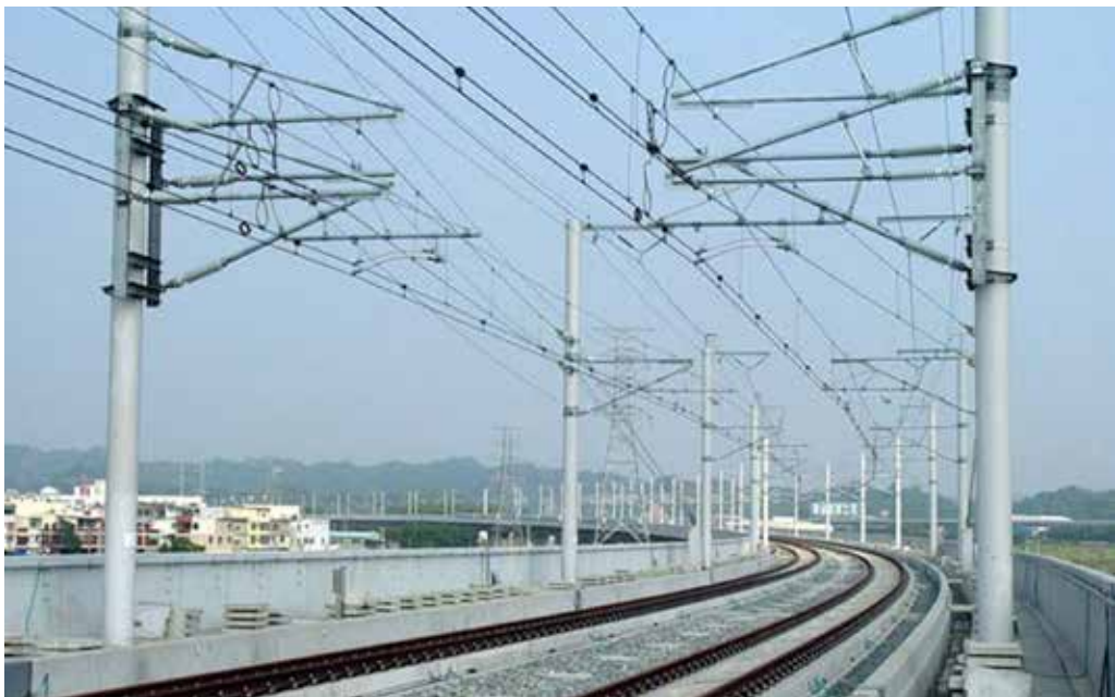
圖 4 電力系統~台灣高速鐵路用鋼柱 (Steel Pole) 全線採熱浸鍍鋅施工
