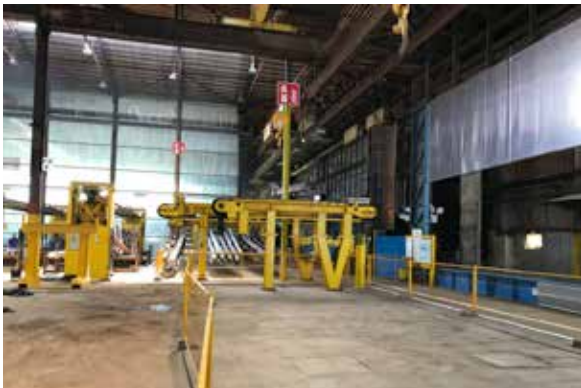
圖 13、右側為鍍鋅爐，左側封閉區為前處理區
