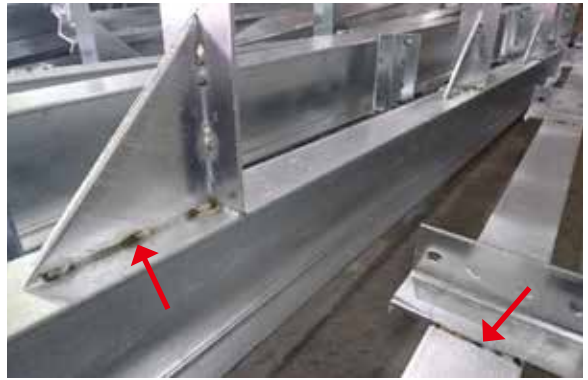
圖 4、銲道銲渣未清除容易產生裸點
