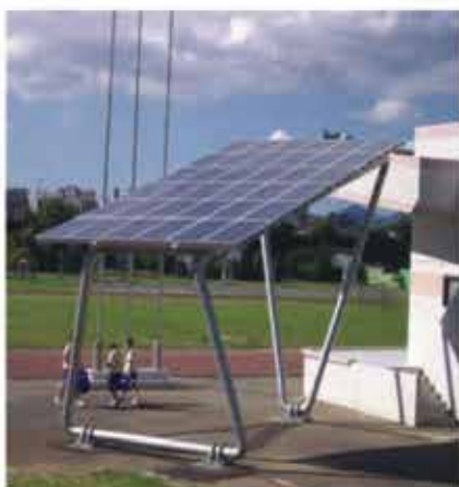
板橋國中太陽光電結構
