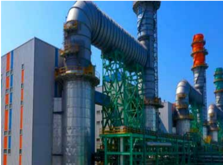
圖 3 熱回收鍋爐廠房 (1~3 號機)。
