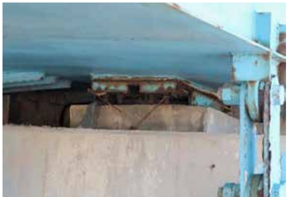
圖 10 支承及防落橋措施銹蝕嚴重。
