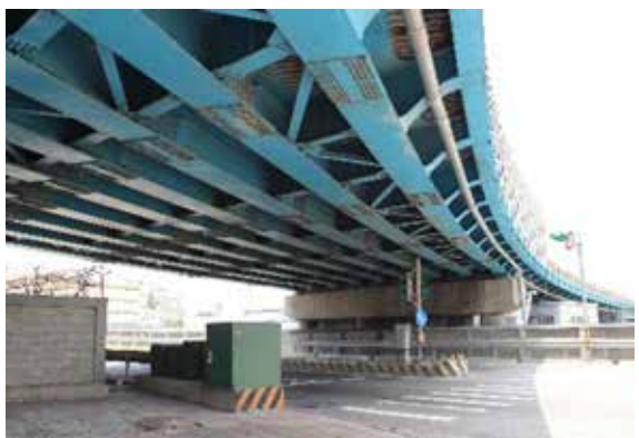
圖 8 跨越台四線段。 (非鍍鋅之 F10T 螺栓銹蝕)
