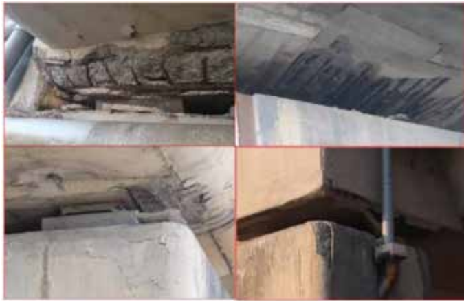
圖 20 上下部結構 RC 調坡塊、止震塊鋼筋銹蝕混凝土剝落。
