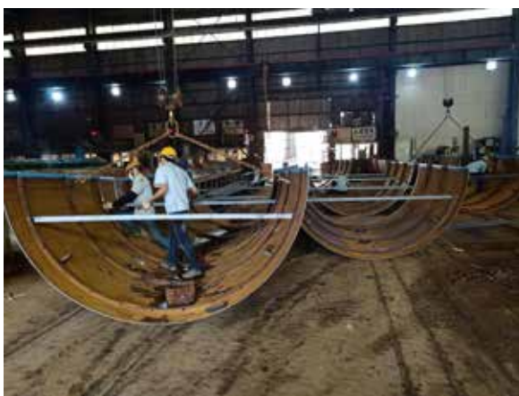
圖 2 橋墩防撞鋼板。
