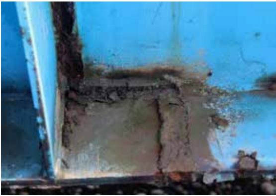
圖 9 引橋邊縱梁銹蝕嚴重。
