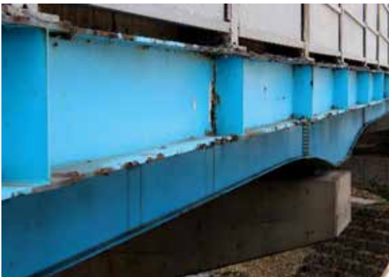
圖 7 引橋段鋼梁銹蝕嚴重。
