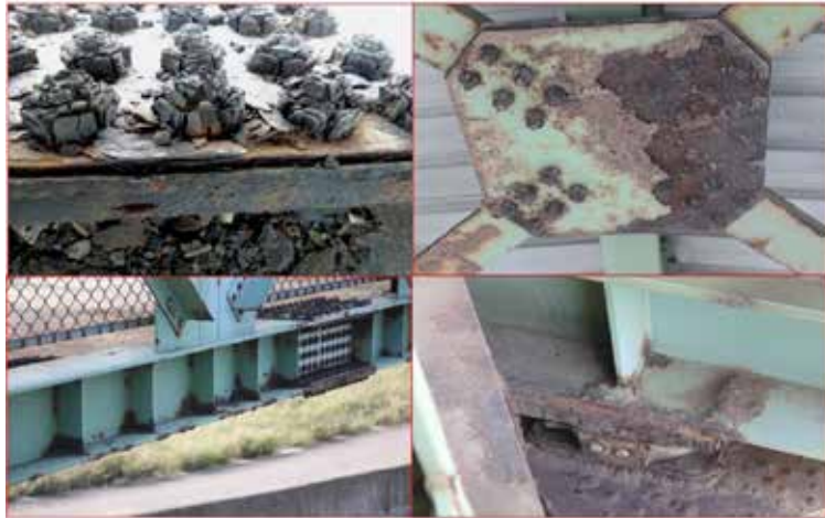
圖 15 人行鋼構陸橋銹蝕情況組圖。
