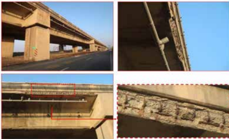
圖 21 橋面外伸版鋼筋銹蝕保護層混凝土剝落。
