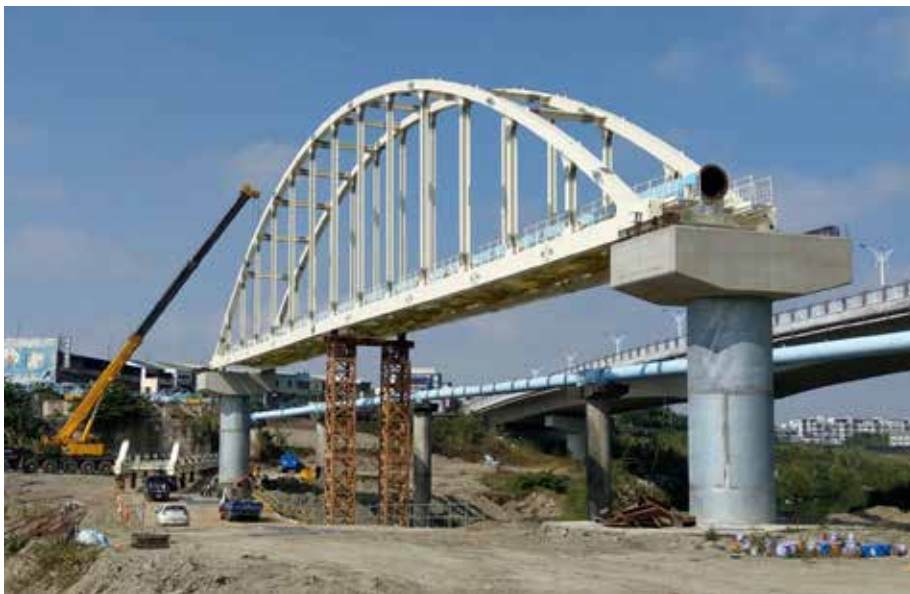
圖 15 橋墩防撞鋼板。
