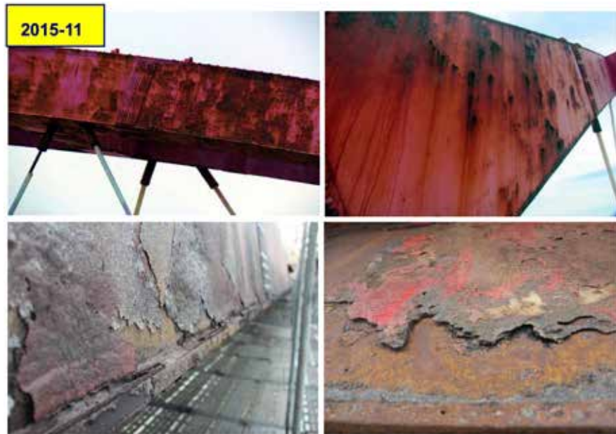
圖 5 2015 年外觀追蹤及塗裝剝落情況。
