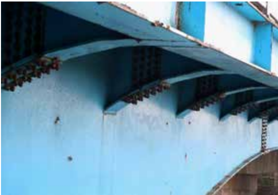
圖 11 螺栓銹蝕嚴重。
